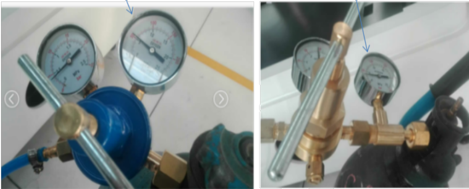
Abbildung 6-4: Komponente des Gaskanals (i)
